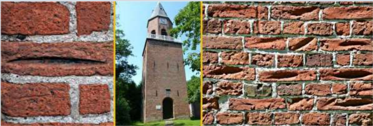
Schabespuren in Backsteine in Wijk bij Duurstede (Foto 1) und in Bellingwolde (Foto 2+3)
